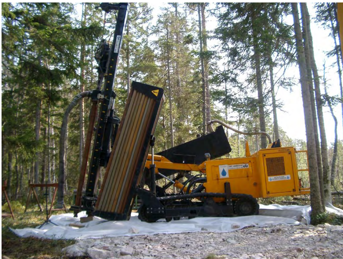
Figur A-5. Hammarborrmaskin uppställd på skyddsduk för att förebygga markförorening och möjliggöra uppsamling av eventuella läckage.
