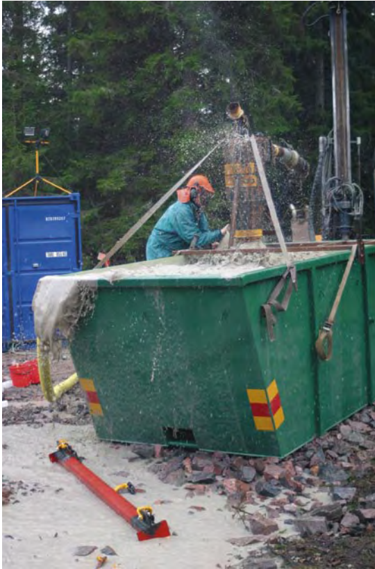
Figur 3-32. Hammarborrning av HFM16, varvid ett inflöde av grundvatten till borrhålet på 1 200 l/min uppmättes.
