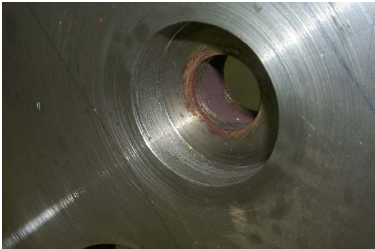
Figur 6-4. Stållockets centrumhål (detalj, översida) med korrosionsangrepp.
