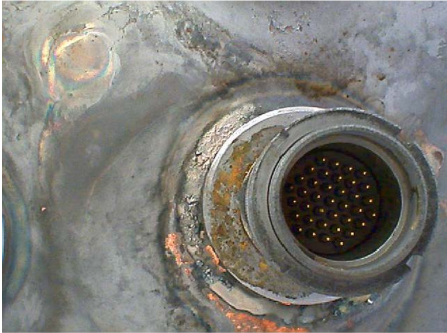
Figur 8-1. Kopparlockets undersida, korrosionsbeläggningar runt plugg för kabel 5.
