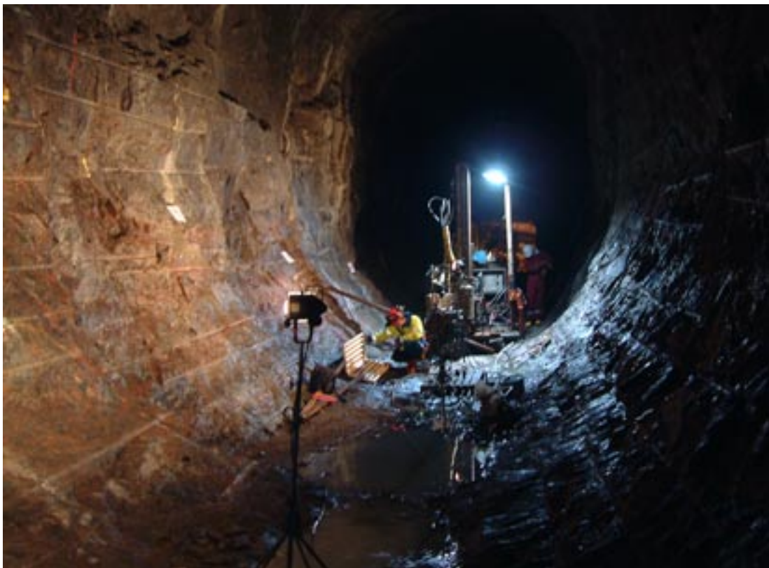
Figur 10-1. Den nya Apse-tunneln vid Äspölaboratoriet som drivits under sommaren 2003 med skonsam borrhning och sprängning.
