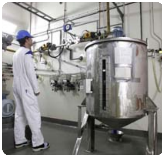
Figur 9-9. Kontroll och utflöde av vatten i Clab.
