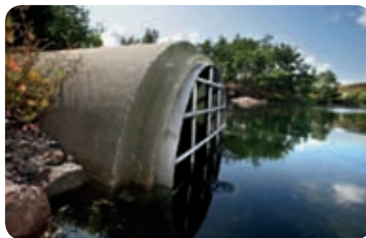
Figur 8-6. Utsläppsrör från reningsverket vid Hamnefjärden.
