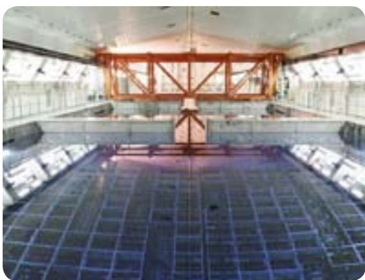
Figur 8-7. Förvaringsbassäng i Clab.
