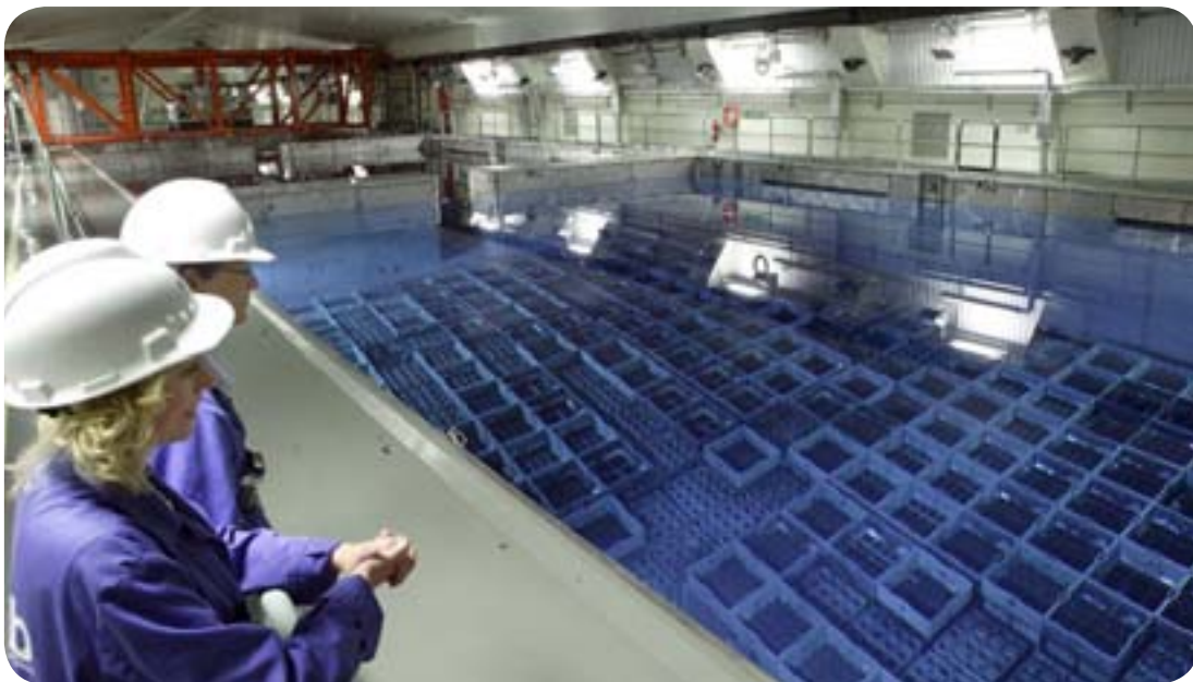
Figur 3-6. Övervakad våt mellanlagring av använt kärnbränsle i Clab.
