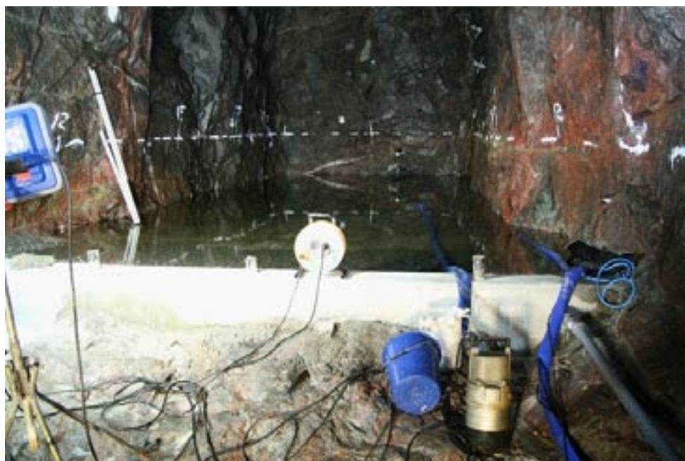
Figur 3-4. Funktionskontroll av mätvall nr 1. Vatten är fyllt innanför mätvallen och nedströms mätvall är berget rensat. Underkant av mätvallen besiktigas okulärt med avseende på vattenläckage mellan betongkonstruktion och berg. Bild: Magnus Kronberg, SKB.
