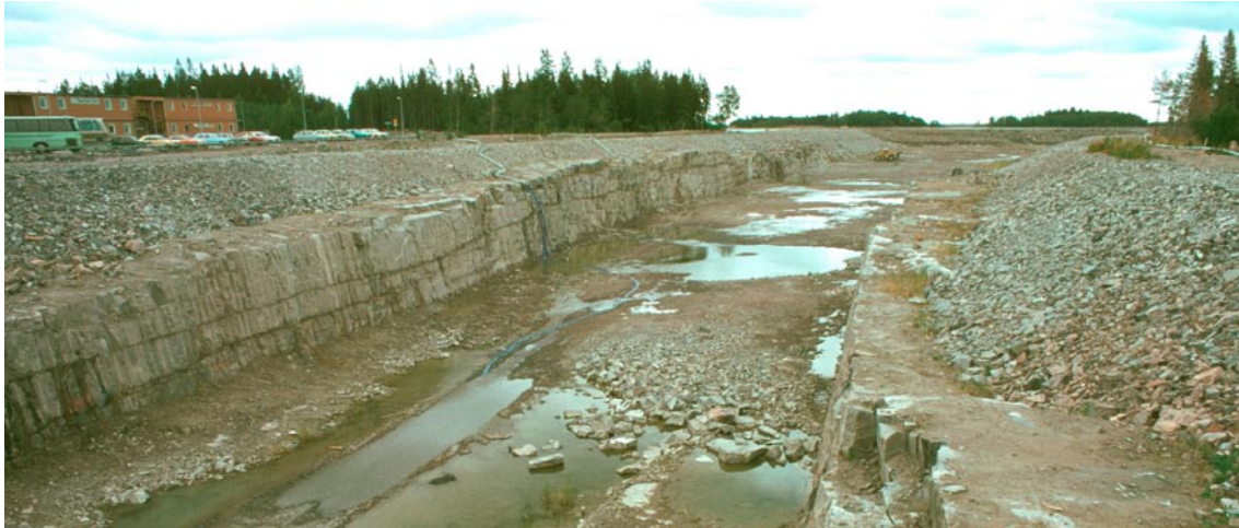
Figur 7-1. Norra sidan av kylvattenkanalen in till Forsmarks kraftverk. Ytliga bankningsplan med storhorisontell utsträckning syns tydligt i bergskärningen. Bilden är reproducerad från /Carlsson och Christiansson 2007/. Foto: G Hansson.
