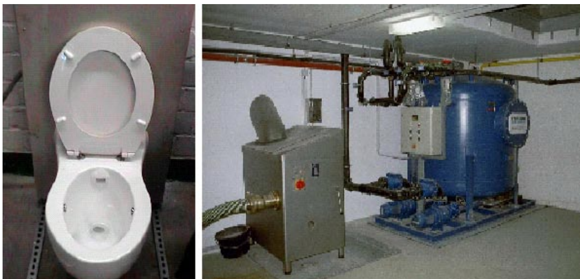
Figur 4-10. Utvecklingen av vakuumsystem sker för närvarande snabbast i Tyskland. Bilden visar vakuumtoalett och vakuumenhet för det nya bostadsområdet Frietenbreite i Lübeck ( www.otterwasser.de/german/konzepte/flibildg.htm ).
